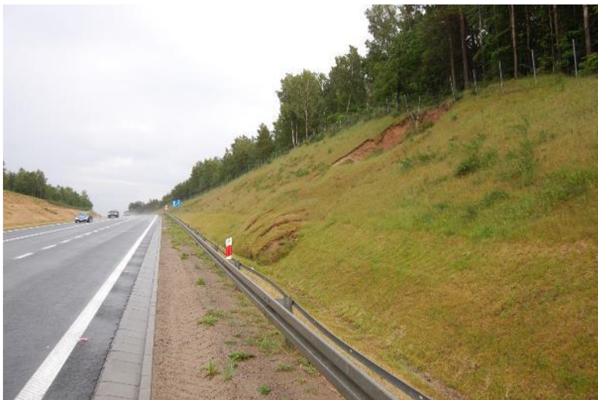
Zdjęcie 13 Osuwisko na skarpie drogowej
