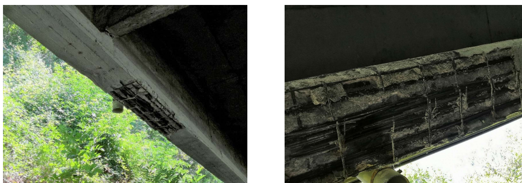
Figura 5-4. Ammaloramento trave di bordo esterna T1
