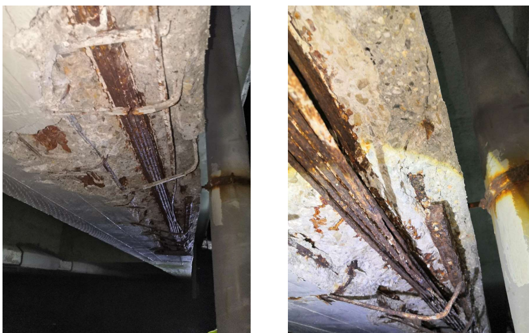
Figura 5-1. Ammaloramento trave di bordo esterna T4
