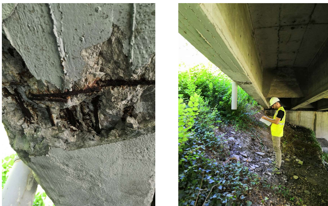
Figura 5-5. Ammaloramento trave di bordo esterna T1
