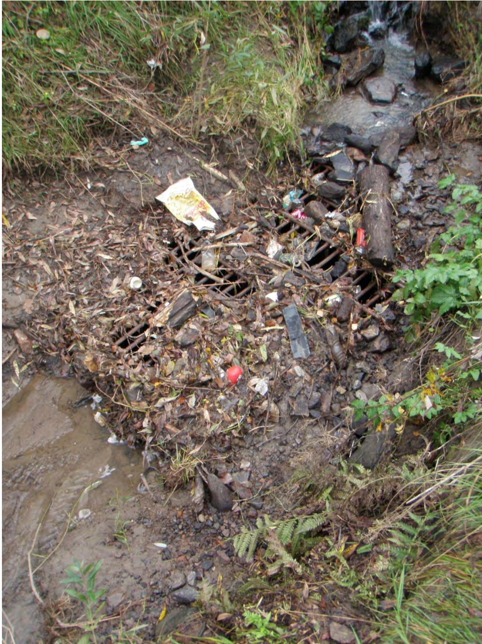
Bild 8. Gallret över störtbrunnen i inloppet till trumman under väg 190.
