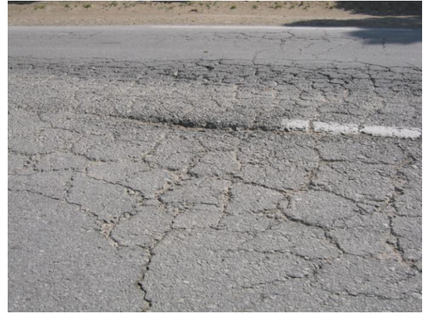
Photo 8 : Faïençage de la chaussée existante
