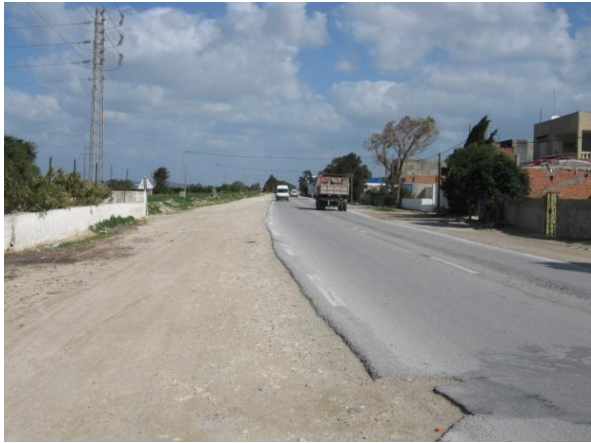
Photo 7 : Dégradation du bord de la chaussée
