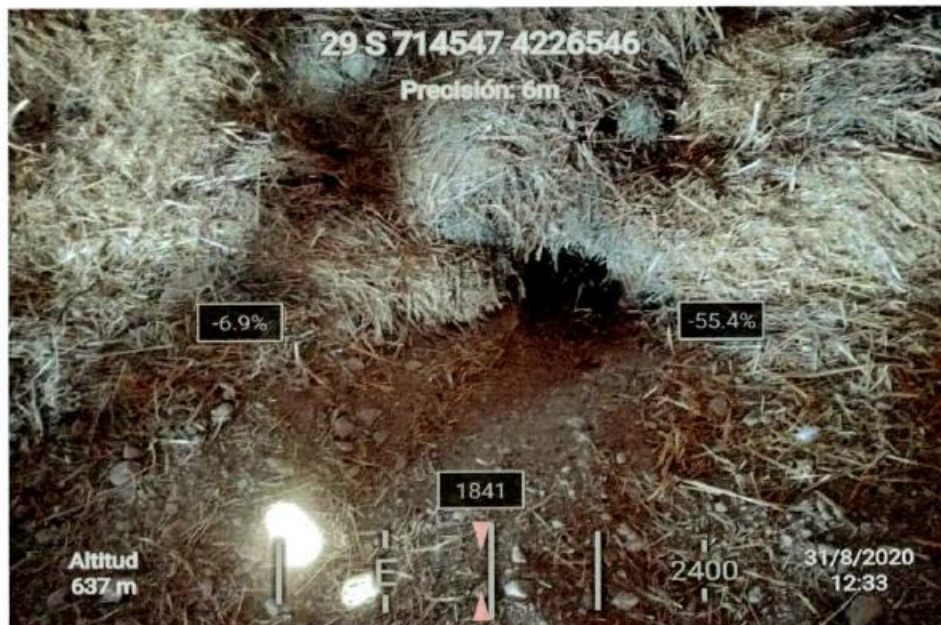
Zorrera dentro de edificio agrario que se quiere derribar en Pol. 5 Parc. 35.
